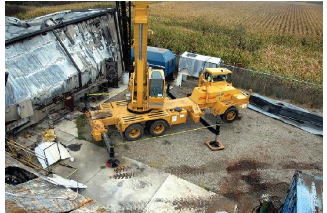
Figura 13.4.2 El radio de giro de la grúa se protegió correctamente.
